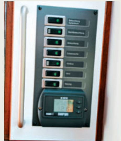
Übersichtlich: Schaltpaneel mit Sicherungen.
