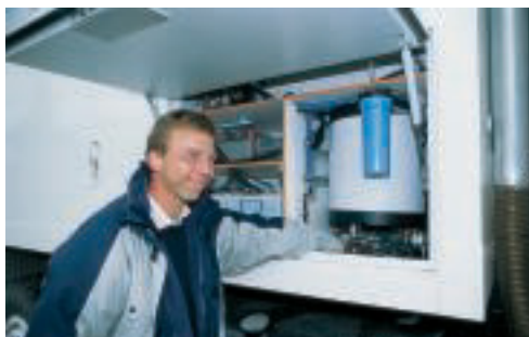
Gut zugängliche Wasseranlage im Technikfach.
