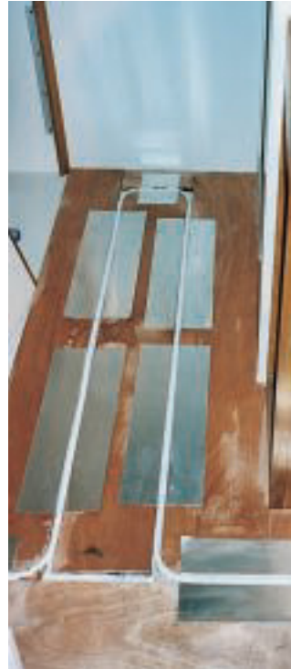
Komfort durch Fußbodenheizung.
